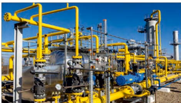
S.C. INSPET S.A., Ploiești Execuția stației de uscare gaze naturale cu trietilenglicol, grup nr.145, Bilciurești
